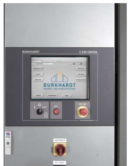
ガス化ユニットのモニター画面（遠隔操作も可能）
